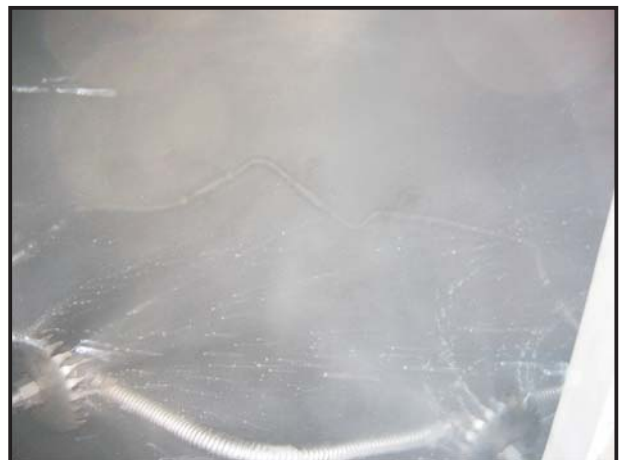
Foto: Im Inneren des Fercher Sprühtunnels, Sprühdüsen
