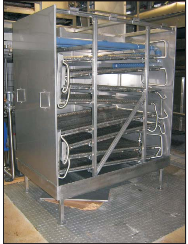
Foto: FERCHER Abwasserwärmetauscher Typ FB-8/S, vor Inbetriebnahme, Seiten- und obere Abdeckungen abgenommen
