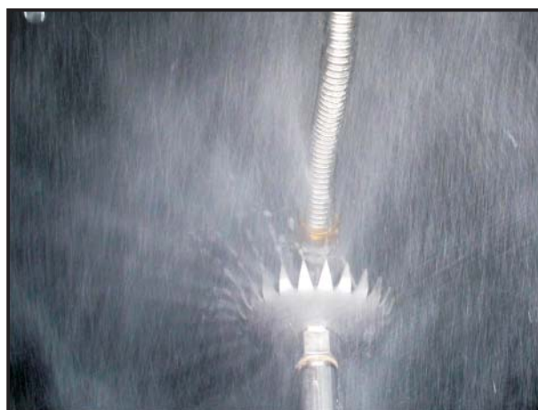
Foto: Im Inneren des FERCHER Sprühtunnels Sprühdüsen im Betrieb, Mannlöcher ermöglichen jederzeit die Kontrolle der Sprühfunktion
