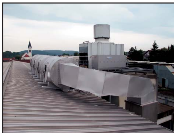
Foto: Einbindung der kompletten Abluft/Dampf von der Kartoffelschälanlage/Dampfschäler in den FERCHER Sprühtunnel
